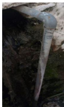
(d) Pipes passing through sewerage lines
